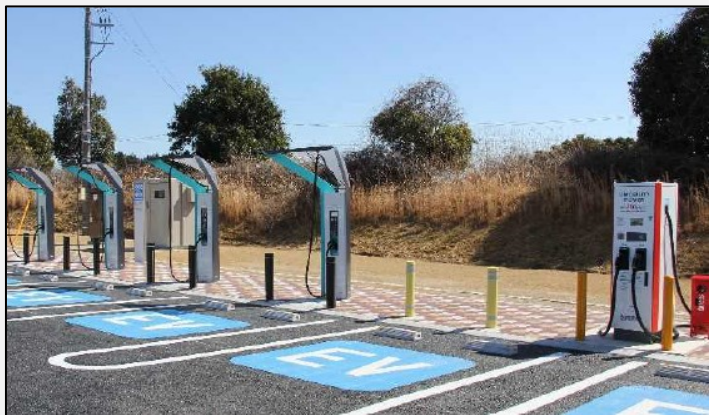
(例)EV充電施設の設置推進
